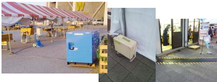
発電機 (容量によってはサイズは変わります)
